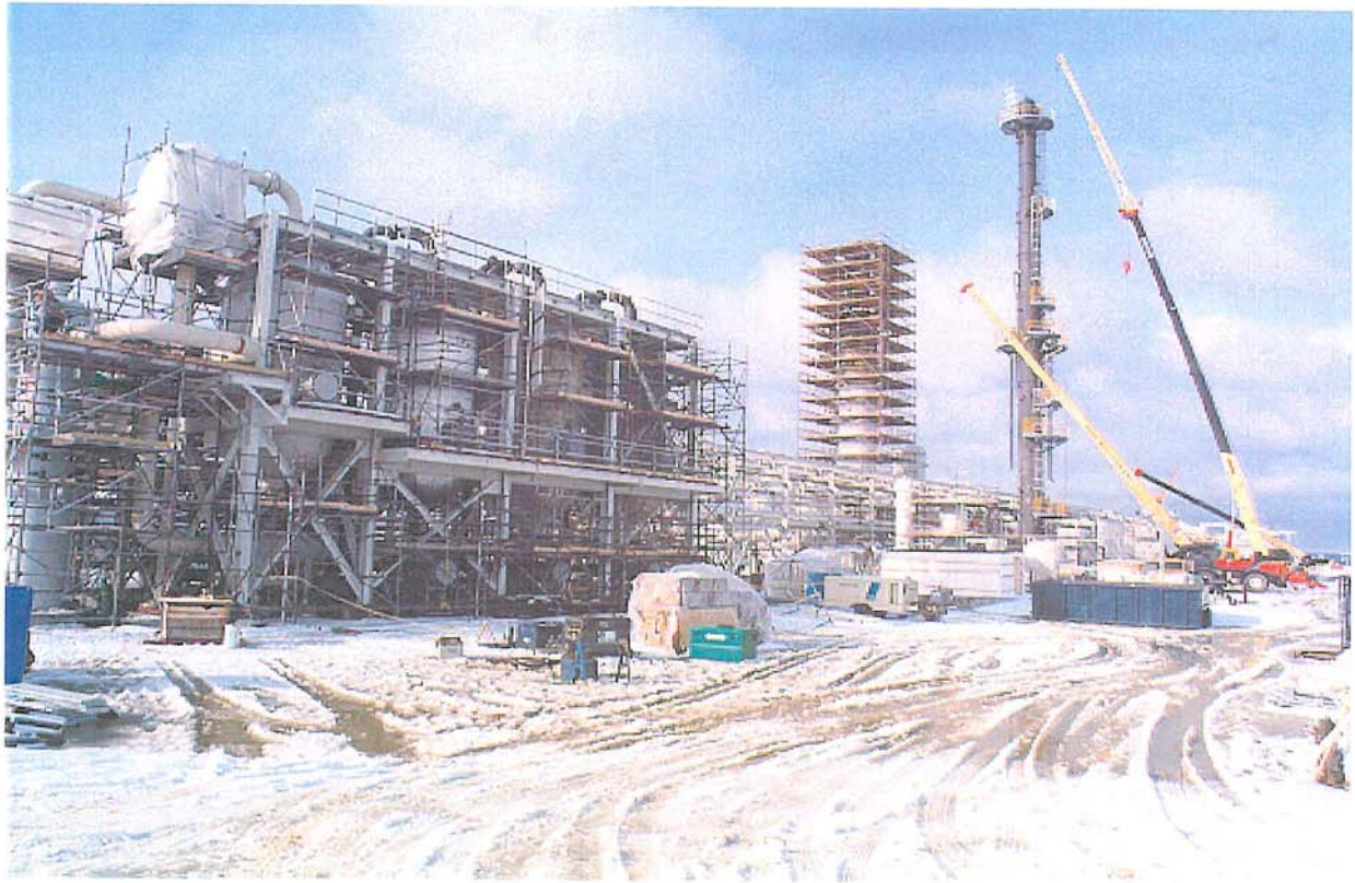
Gas Plant, Goldboro, N.S.
